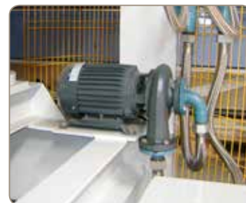
Ölförderpumpe für Thermoöl
